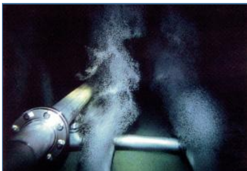
せっしょくち オゾン接触池
