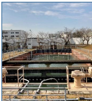
ちんさち 沈砂池
