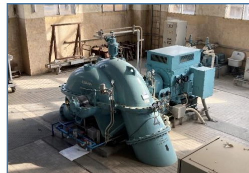
しゅすい 取水ポンプ
